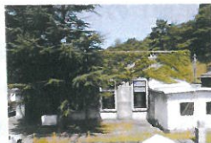
送水ポンプ室 鋼骨コンクリート造で、ポンプを駆動し、ろ過水をろ過した水を配水池まで送給する施設です。ロケット型の設計が特徴となっており、その形状が配水池との接続が容易になっています。(写真：平山博明撮影)
