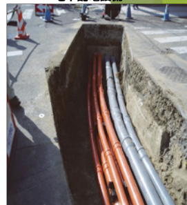
地中配電設備
